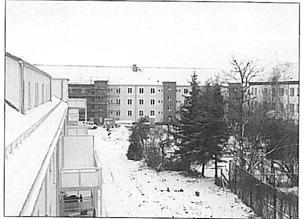
Blick auf die Freiherr-vom-Stein-Straße in der Gartenstadt Westernplan. Die Sanierung dieses Wohnhauses wird in Kürze abgeschlossen.
